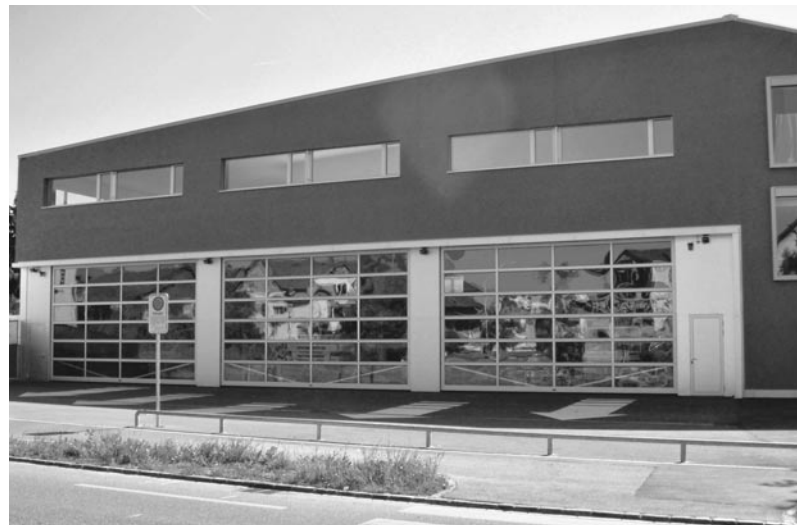
Die Schliessanlage im Feuerwehr- und Werkgebäude muss ersetzt werden.
