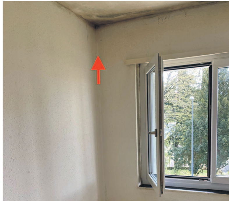
Gebäudeecken sind Wärmebrücken mit häufigem Schimmelpilzbefall.
