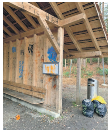
Sachbeschädigung durch Farbkugeln in der Waldhütte Möslhalden.
