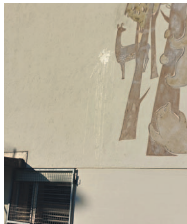
Eierwurf an die Fassade vom Schulhaus Ohringen.
