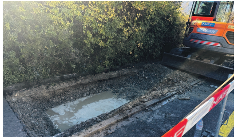
Leitungsbrüche sorgten 2024 für einen Verlust von rund 58m³ Trinkwasser.
